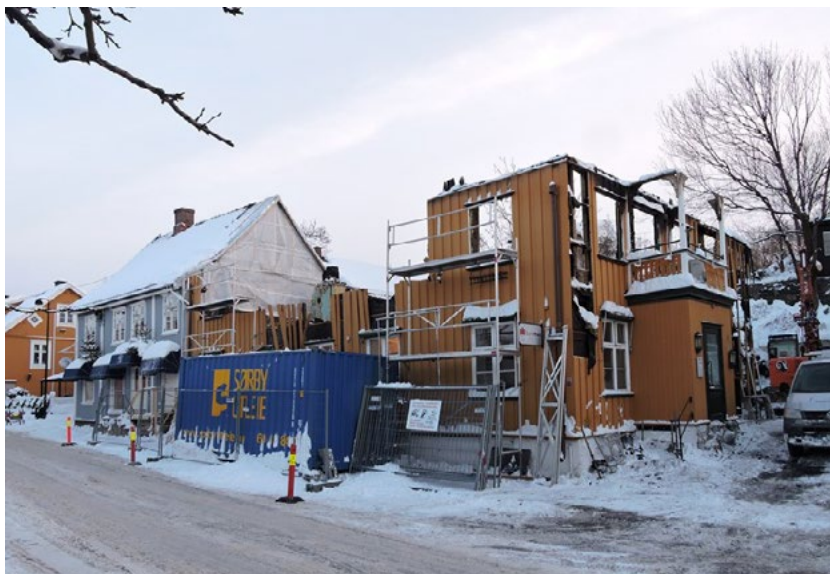
Figur 26: Januar 2016, etter at det gjenværende tømmeret i 2. etasje var merket og demontert. Foto: Per-Willy Færgestad.
